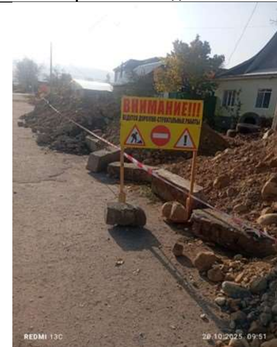
Установлены многоязычные предупреждающие знаки об опасности, а также выполнено ограждение красно-белой сигнальной лентой (обеспечен эффективный контроль по периметру вокруг зоны траншей, ограничен несанкционированный доступ и снижен риск падения)
