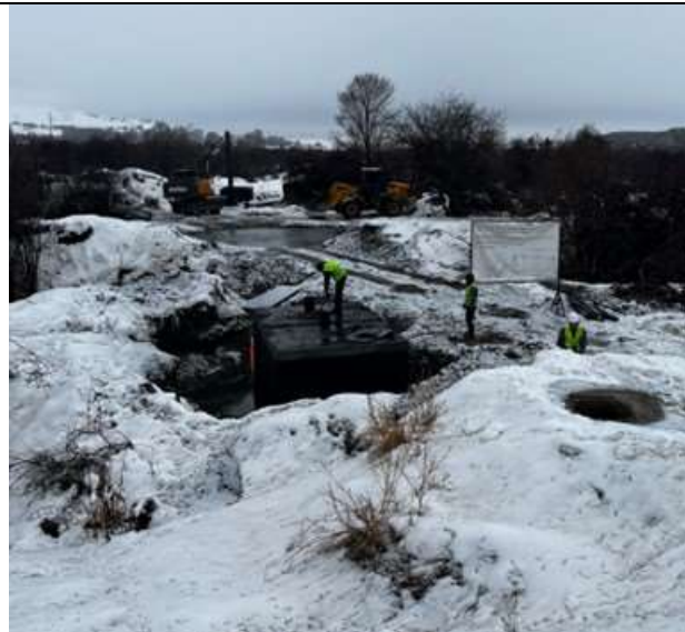
На площадке установлены информационные щиты, рабочие обеспечены сигнальными жилетами повышенной видимости и защитными касками
